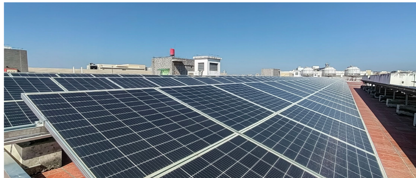
科华屋顶光伏
